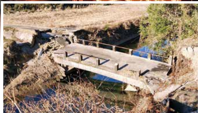
令和6年10月豪雨災害現場状況（堂園橋）
