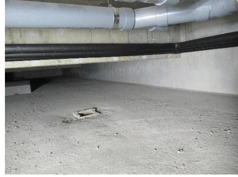
写真2 地下配管ピット
