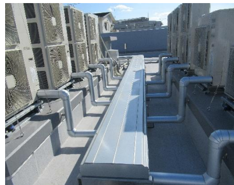
写真8 空調室外機配管保護カバー
